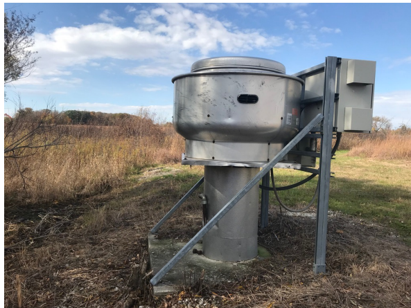
ODH fan and ductwork
