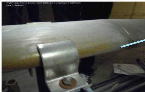
MI rusted pipe
